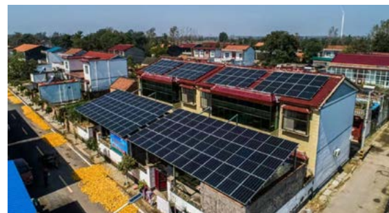
本行支持的兰考县户用光伏发电项目
